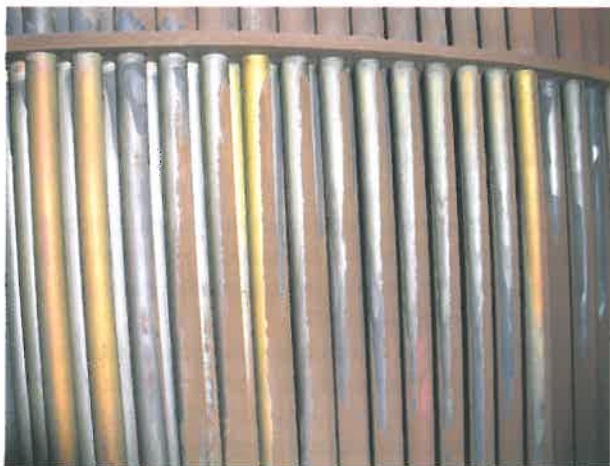
Rys. 7–8. Powierzchnie po stronie parowej wymienników chłodnicy CT-2 i regeneracji niskoprężnej
