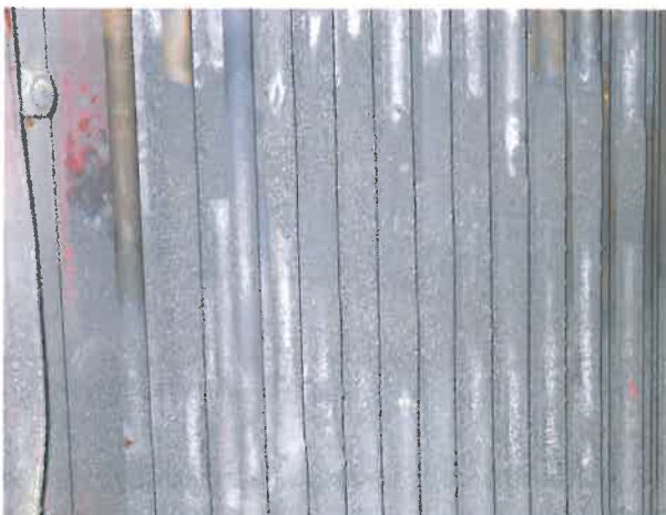
Rys. 9–10. Powierzchnie po stronie parowej wymienników regeneracji średnioprężnej po wykonanym procesie chemicznego czyszczenia
