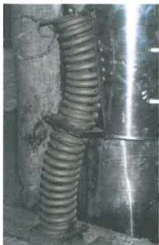
Rys. 3. Wybozczone sprężyny przeciążonego zamocowania sprężynowego
