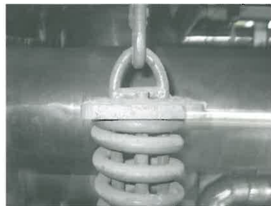
Rys. 13. Zablokowane zawieszenie sprężynowe, talerzyk zablokowany o poprzeczkę
