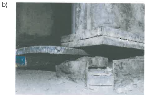
Rys. 17. Zbyt mała jezdnia dwukolumnowej podpory pionowej, która dodatkowo nie uwzględnia odchylenia rurociągu od pionu: a) zbyt mała powierzchnia jezdni powoduje wysuwanie się zespołu kulowego b) brak przegubu uchylnego dwukolumnowej podpory kulowej powoduje, że jedna ze stóp unosi się w górę o kilkanaście mm
