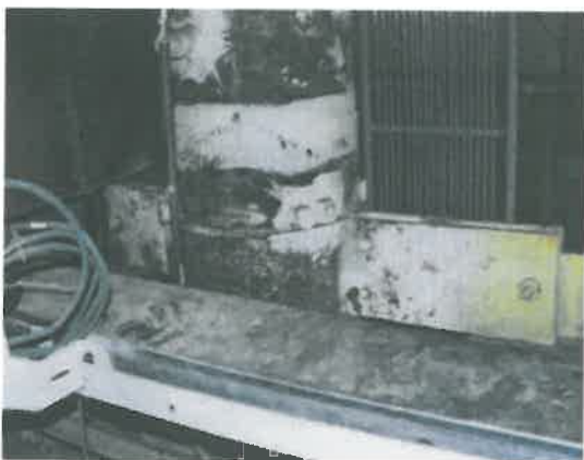
Rys. 16. Obejma pionowa o zbyt małej sztywności
