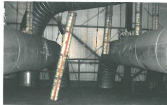
Rys. 9. Pozrywana linia zamocowania wielokrążkowego sześciokrotnego na rurociągu pary do wtórnego przegrzewu bloku 200 MW
