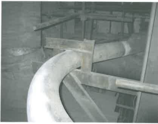
Rys. 14. Blokada montażowa pozostawiona przez ekipy blokujące rurociąg
