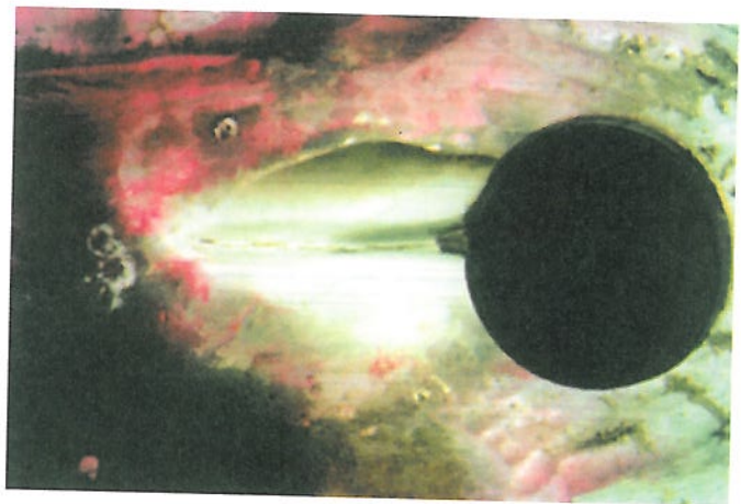
Rys. 6. Ubytek „na wylot” po usunięciu pęknięcia i towarzyszącej mu rzadziny na krawędzi otworu wpustu w dolnej części kadłuba zewnętrznego turbiny 13UP-55-7; na przeciwległej tworzącej otworu widoczna nie usunięta rzadzina
