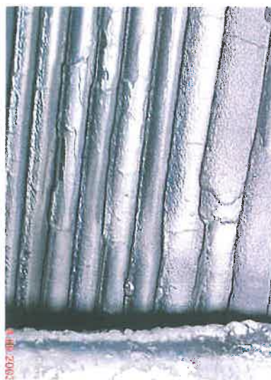
Rys. 9. Osady na powierzchni zewnętrznej wymiennika
