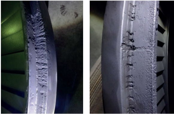
Rys. 5. Ubytki erozyjne na powierzchniach osadczycy (powierzchnia uszczelniająca)
