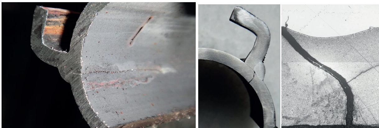
Rys. 9. Przejrzewacz pary świeżej II st. (stal X20) – pęknięcie w SWC w obszarze spoiny zamocowania
