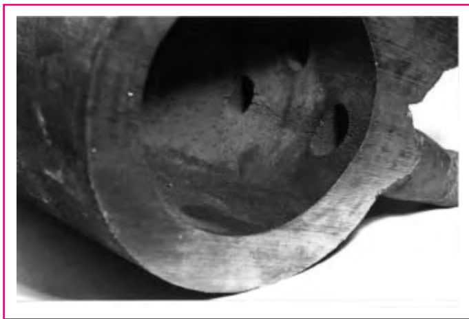
Rys. 4. Pęknięcia pełzaniowe, komora pary przegrzanej po przepracowaniu 130 000 h, materiał 10H2 M, D_z/D_w > 1,3 mm, nieznaczne przekroczenie temperatury ścianki
