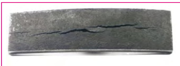
Rys. 5. Pęknięcie rurociągu pary świeżej, kolano po przepracowaniu 150 000 h, materiał 13HMF, D_z/D_w > 1,3 mm. Przekroczenie nominalnego czasu pracy.
