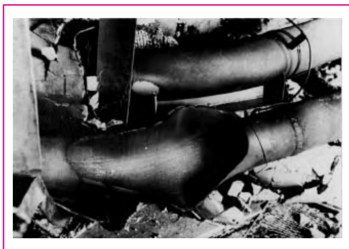
Rys. 3. Uszkodzenia rurociągu komunikacyjnego (komora wylotowa przegrzewacza do schładzacza). Materiał 15HM, przepracowana liczba godzin 15 000 h, D_2/D_w < 1,3 mm. Przyczyna przekroczenia obliczeniowej temperatury ścianki.
