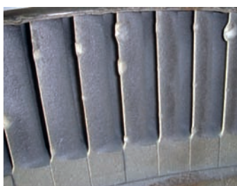
Rys. 20. Uszkodzenia ciałem obcym, krawędzi wylotowej. Turbina 200 MW, wirnik WP
