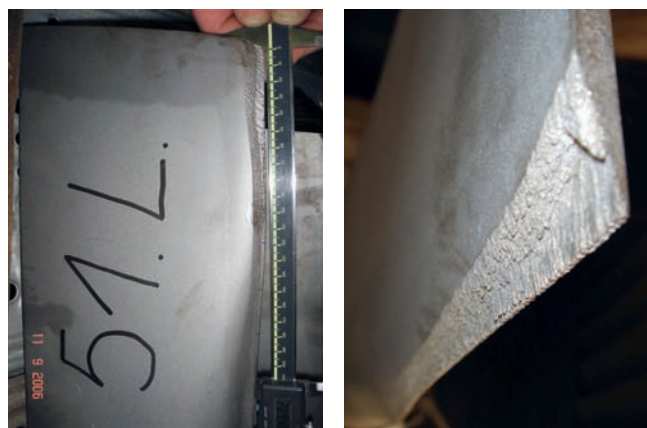
Rys. 3. Ubytki erozyjne na krawędzi wlotowej. Turbina 360 MW, wirnik NP
