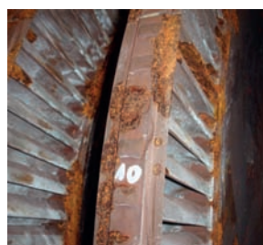
Rys. 21. Korozja postojowa. Turbina 100 MW, wirnik NP
