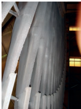
Rys. 6. Ubytki erozyjne na krawędziach wlotowych. Turbina 200 MW, wirnik NP
