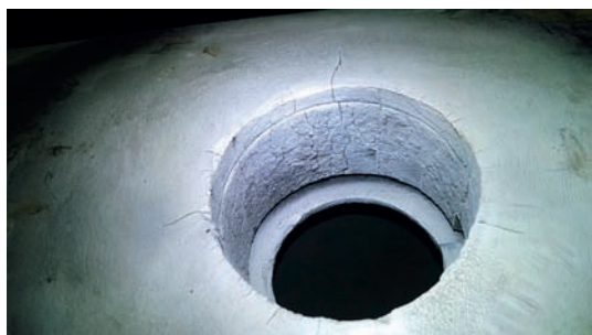
Rys. 8. Pęknięcia słoneczkowe otworu pod króciec aparatu wtryskowego; zdjęcie wykonano po odcięciu króćca oraz po badaniach MT
