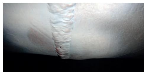
Rys. 10. Wybrzuszenie na dolnej tworzącej komory schładzacza spowodowane zaleganiem wody
