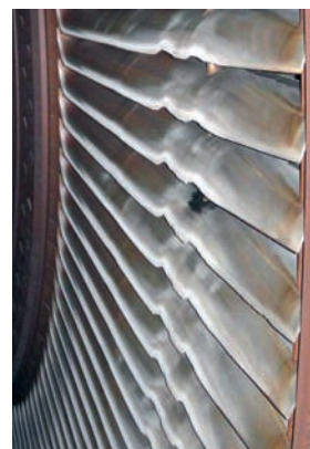
Rys. 15. Ubytki erozyjne na krawędziach wylotowych. Turbina 120 MW, wirnik NP
