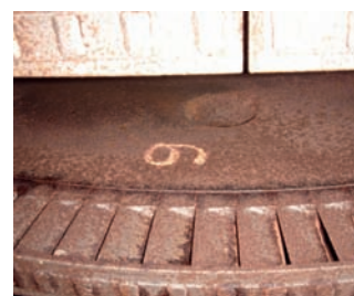
Rys. 22. Korozja postojowa. Turbina 30 MW, wirnik NP
