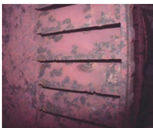
Rys. 23. Korozja postojowa. Turbina 25 MW, wirnik turbiny
