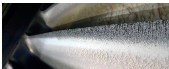
Rys. 11. Ubytki erozyjne na krawędziach wylotowych. Turbina 200 MW, wirnik NP
