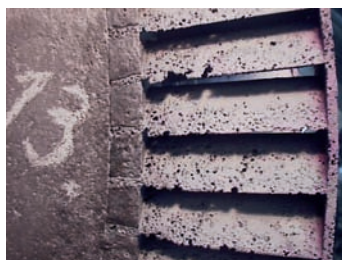
Rys. 24. Korozja postojowa. Turbina 25 MW, wirnik turbiny
