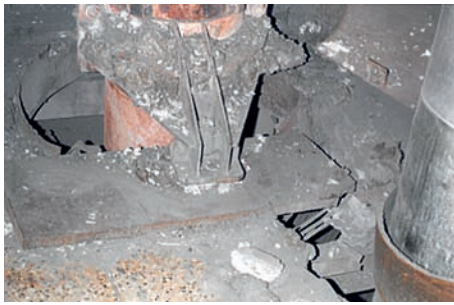
Rys. 1. Zmiana położenia podpory suwliwej rurociągu pary do wtórnego przegrzewu po uderzeniu hydraulicznym
