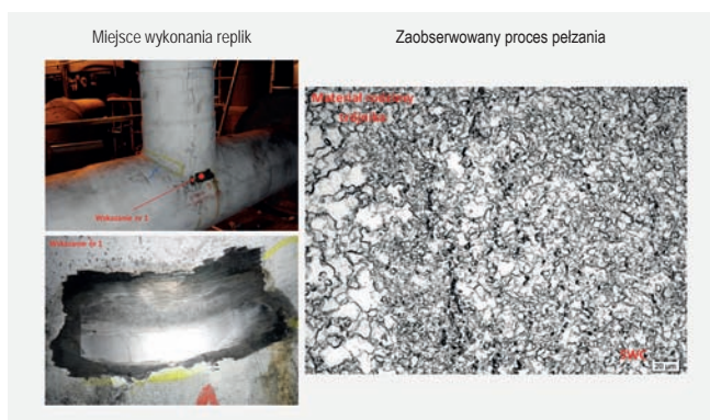
Rys. 16. Rzeczywiste miejsca występowania uszkodzeń o charakterze pęzaniowym
